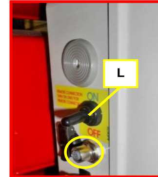
Figure 87 : boîtier de démarrage sur châssis.
